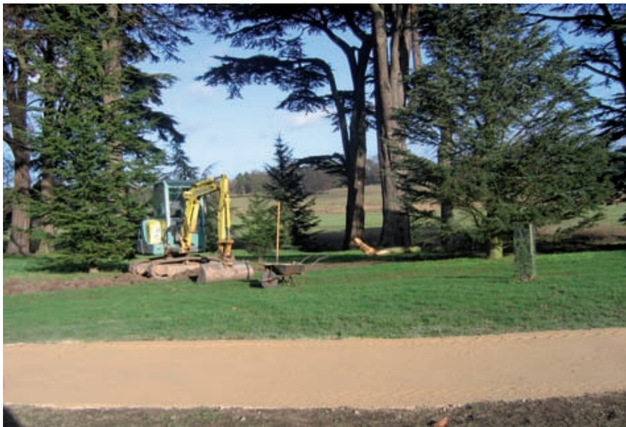
Fig. 3.10: Desplazando la zona de riesgo: desviación de un camino bajo árboles viejos con tendencia al desgaje de ramas.
